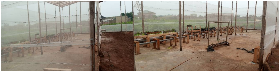
Planche 4 : Etat actuel de l'installation du système de production hors-sol sur le site de Abomey-Calavi
